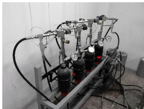
Figura 4.24 - Sistema de controlo da pressão do óleo
